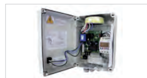
12 Cuadro eléctrico para motor tubular cubierta sumergida
